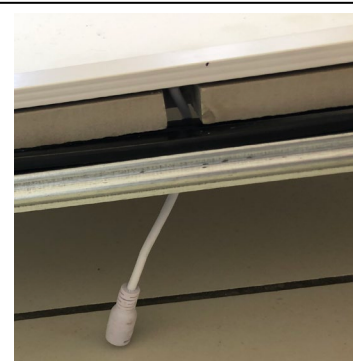
Fig 34 Ejemplo de pasaje para cables alimentación
